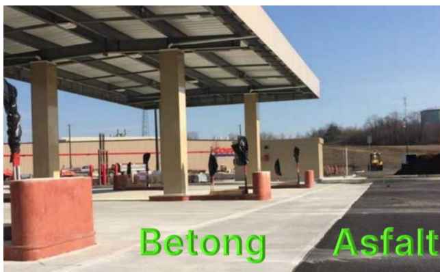
Figur 3. Exempel på fog mellan asfalt och betong på bensinstation vid Costco i Orillia. Källa: https://www.densona.com/product-groups/denso-road-products/ .
