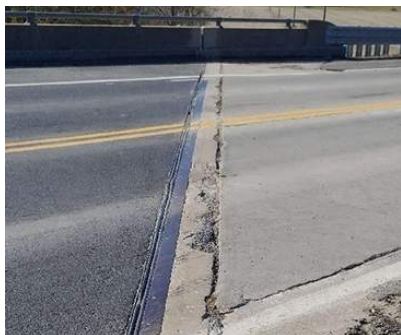
Figur 7. Skadad fog mellan asfalt och betong i Carroll County US Rte 24 bro över BNSF RR. Källa: https://www.modot.org/projects/us-route-24-bridge-rehabilitation-carroll .
